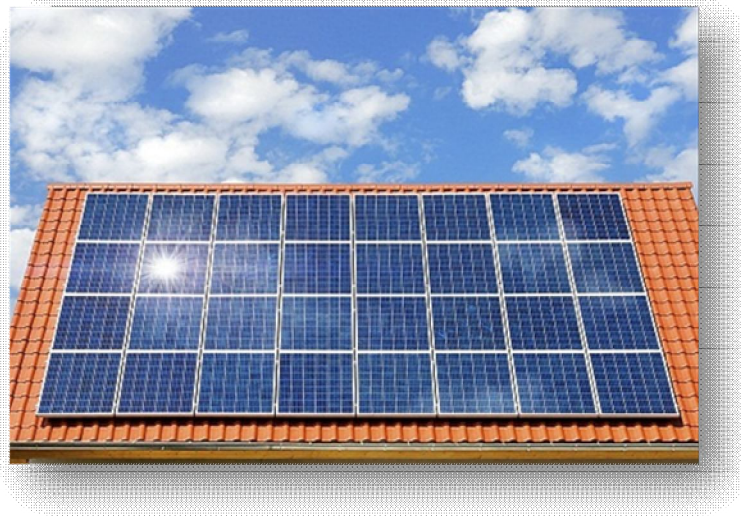
Σχήμα 5.10: Φωτοβολταϊκά πλαίσια σε στέγη
