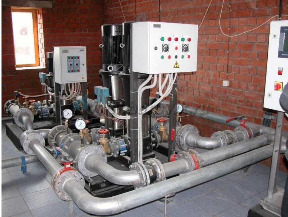
Figure 37 Stație de pompare (poză simbol)
