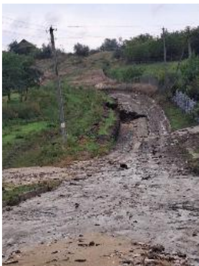
Drumul extravilan erodat din cauza ploilor torențiale
