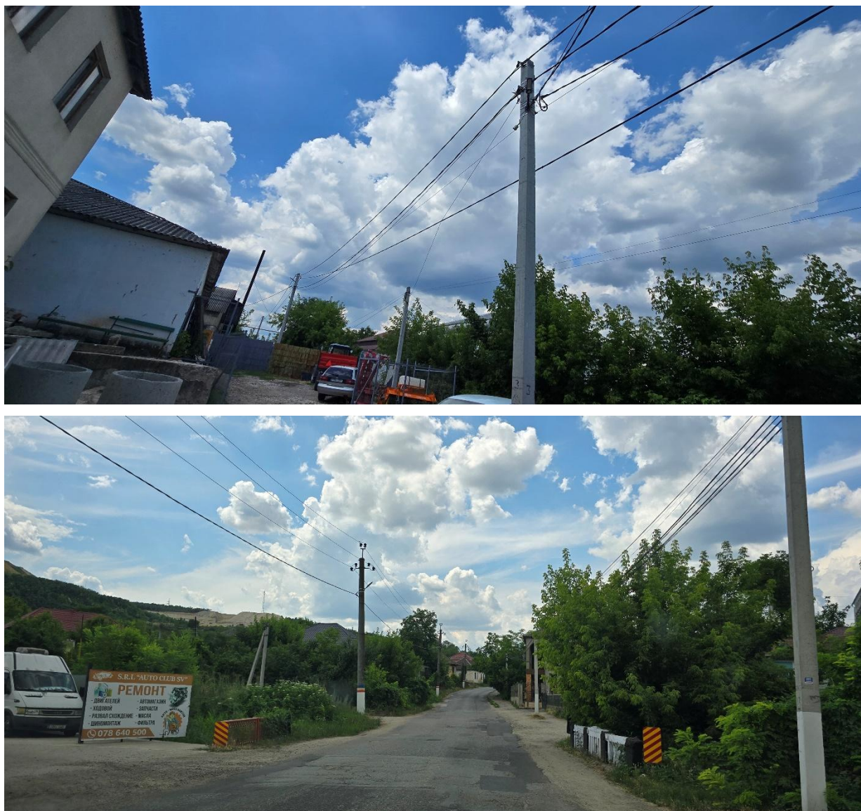
Figura 3. Iluminat public cu corpuri de iluminat LED în or. Otaci
