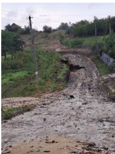
Drumul extravilan erodat din cauza ploilor torențiale
