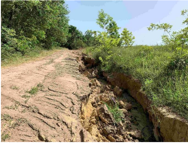
Drumul extravilan erodat din cauza ploilor torențiale
