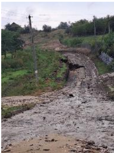
Drumul extravilan erodat din cauza ploilor torențiale
