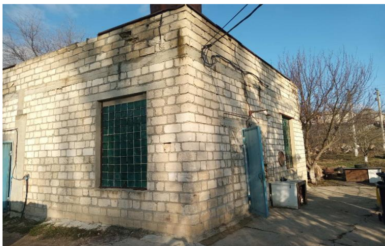
Figura 33 Stația de pompare
