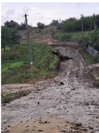
Drumul extravilan erodat din cauza ploilor torențiale
