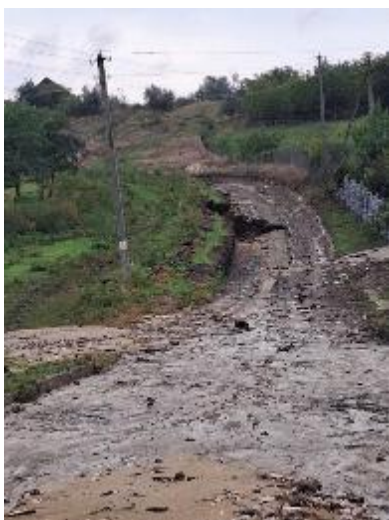
Drumul extravilan erodat din cauza ploilor torențiale
