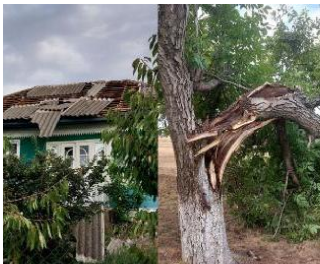
Copacii căzuți din cauza vântului puternic în timpul ploilor
