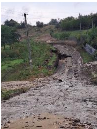
Drumul extravilan erodat din cauza ploilor torențiale
