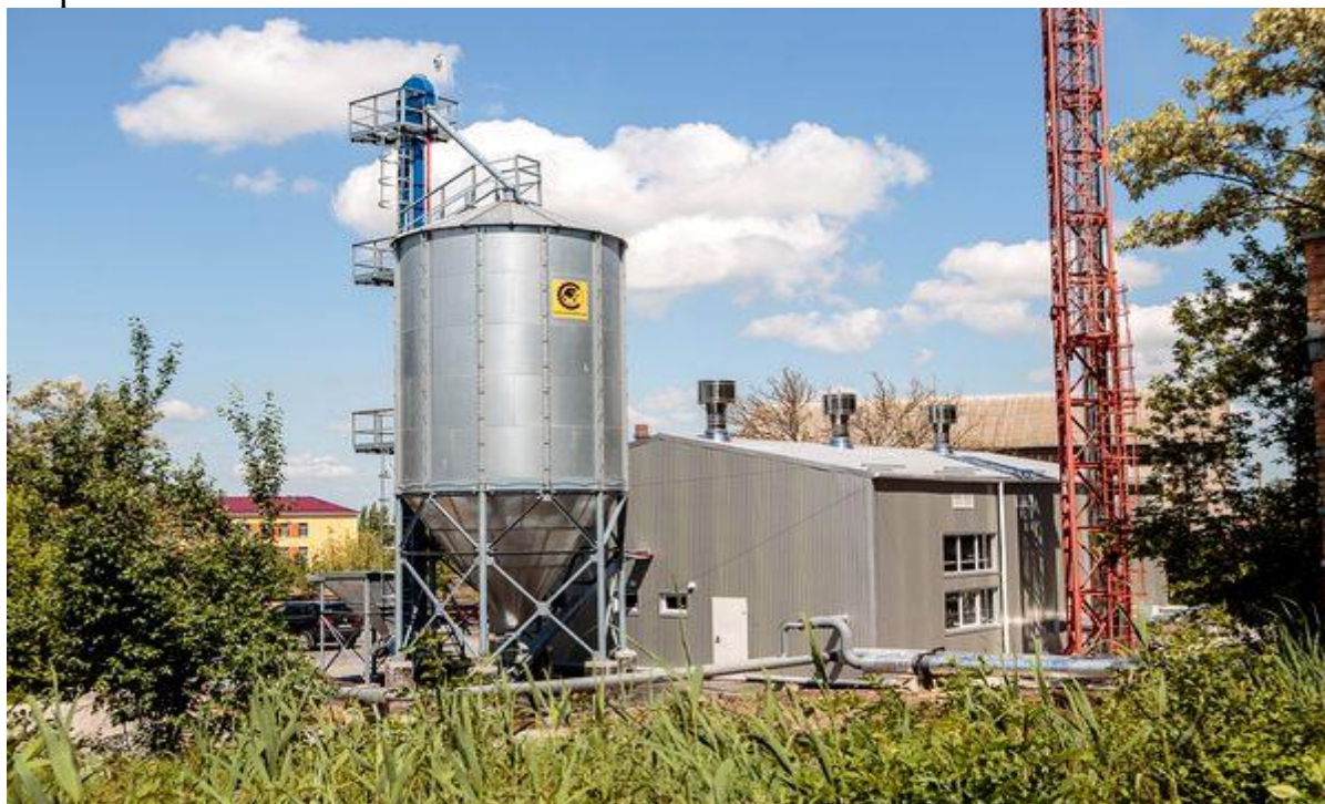
Рисунок 6.3. Приклад біопаливної котельні для теплозабезпечення громадської будівлі
