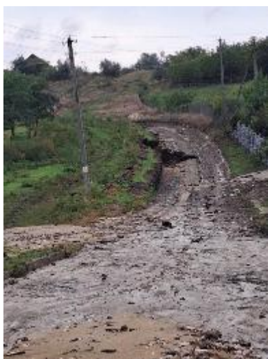
Drumul extravilan erodat din cauza ploilor torențiale
