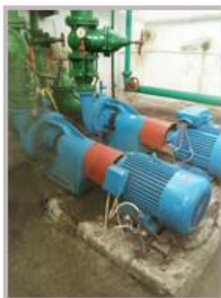
Каналізаційна насосна станція №2(3)
