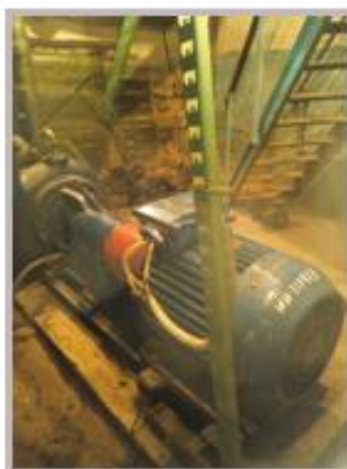
Каналізаційна насосна станція №2(2)
