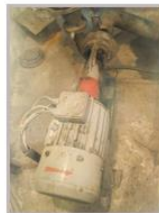
Каналізаційна насосна станція №2(1)
