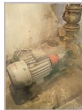
Каналізаційна насосна станція №2
