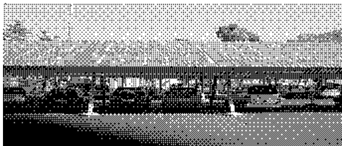
Figura n. 7 - Esempi di installazioni fotovoltaiche su pensiline
