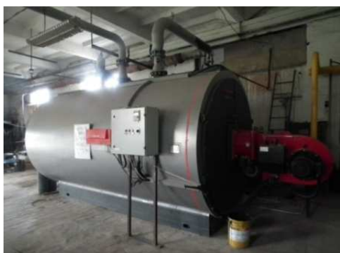
1.7.a. att. Dabasgāzes katls Rīgas ielā 19, Saldū
