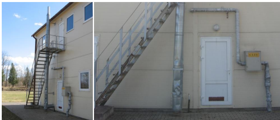
7. att. Birzgales pamatskola un tās katlu mājas gāzes pievads un skurstenis
