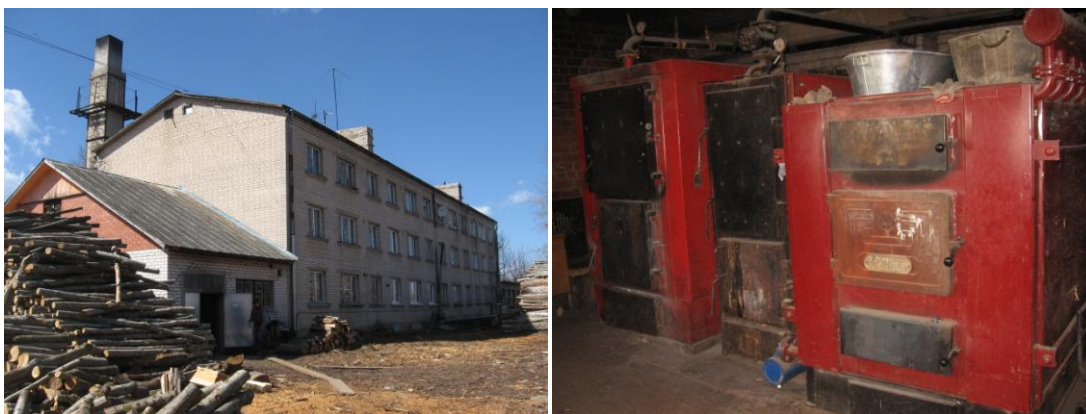
6. att. Centralizētās siltumapgādes katlu māja Birzgalē
