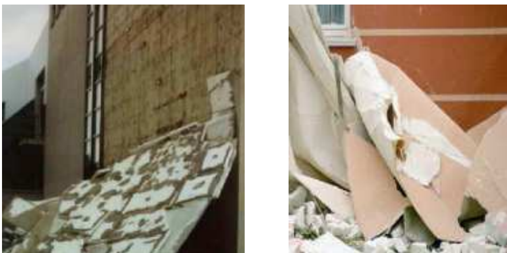
Fig. 12.2: esempio di cappotti termici eseguiti non ad "opera d'arte"
