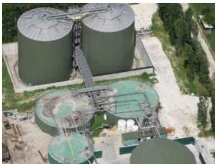
Fig. 39 Impianto di digestione anaerobica SESA (Fonte. http://www.sesaeste.it/ ).
