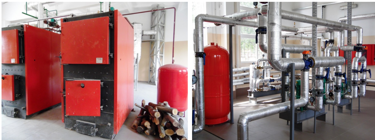
Рис. 4. Модернізована котельня з твердопаливними котлами на вул. Шкільна 13. Джерело: КП Білоцерківтепломережа .
