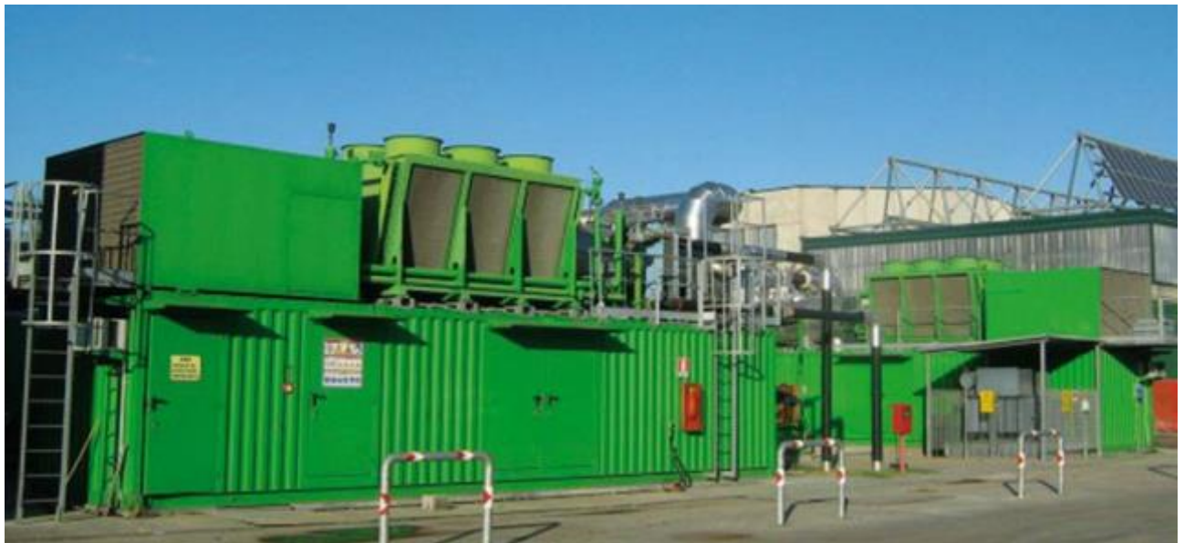
Figura 14: Gruppo elettrogeno impianto SESA di Este
