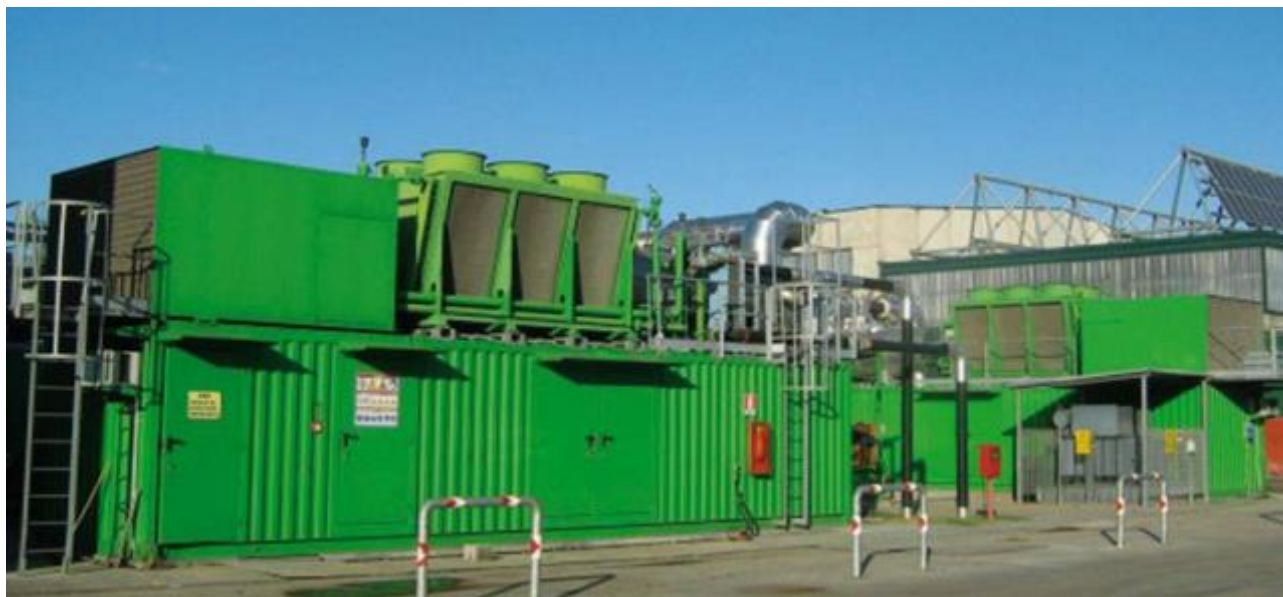
Figura 8: Gruppo elettrogeno impianto SESA di Este
