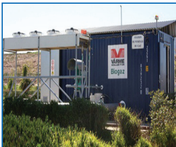
Figure 5 – Le centre de traitement et de valorisation des déchets d'Oujda Source : Maghreb Araba Press (MAP)
