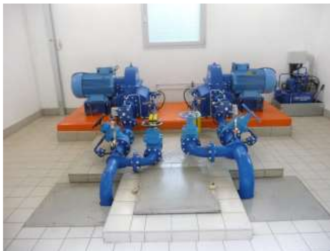
Figura 14: Nuova centralina "in Sella" composta da due mini turbine
