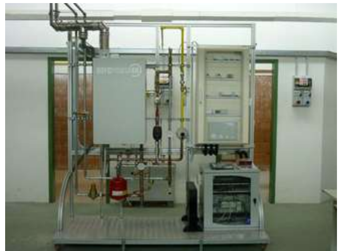
Figura 34: Impianto fuel cell posizionato al CFP di Borgo
