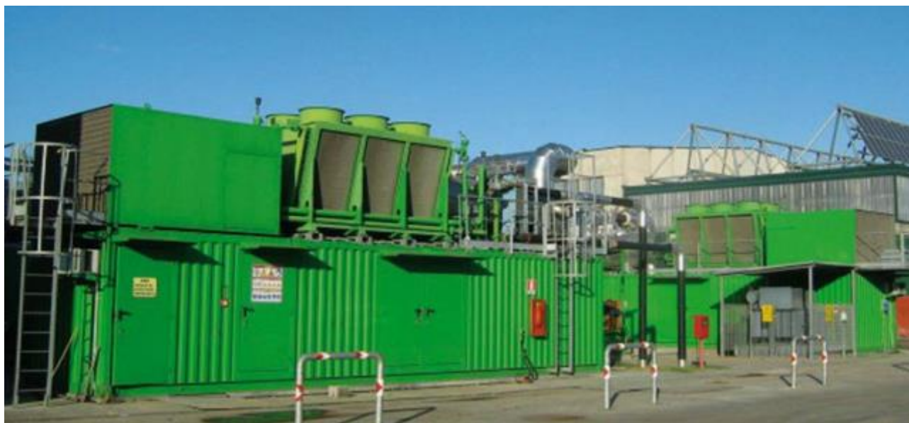
Figura 9: Gruppo elettrogeno impianto SESA di Este
