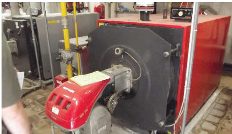
Fig. 6.1 – Foto della attuale centrale termica della scuola media con palestra.
