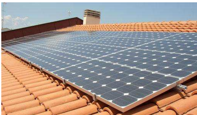
Figura 5 Pannelli fotovoltaici per uso domestico
