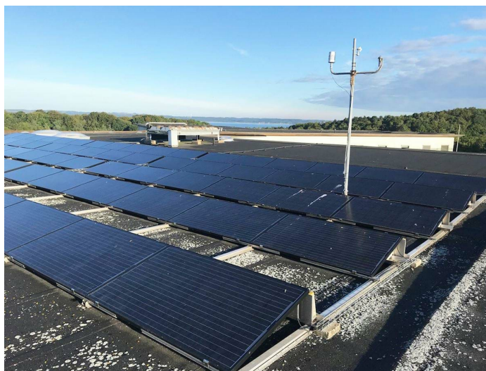
Solceller på Rådhuset
