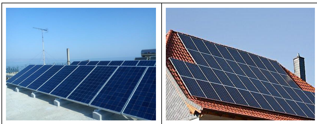
Εικόνα 6: Παραδείγματα εγκατάστασης Φ/Β σε στέγες
