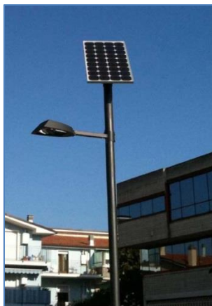
Εικόνα 8: Κολώνα φωτισμού με φωτοβολταϊκό πάνελ
