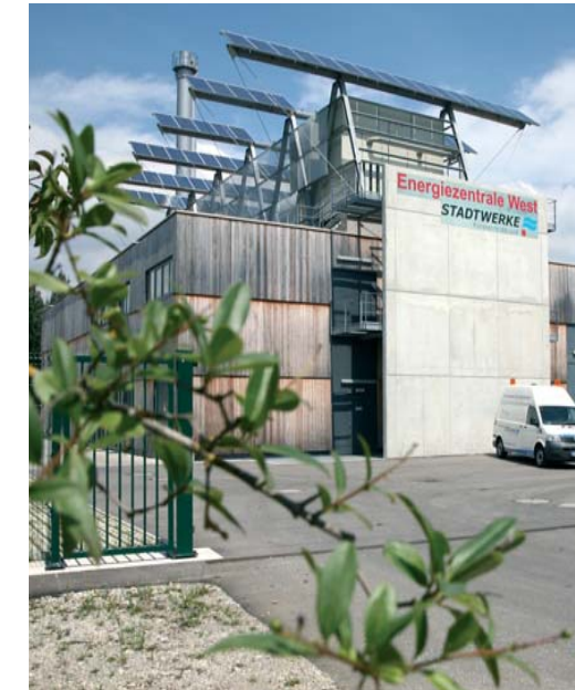
Die Biomasseanlage wird mit ca. 7.000 Tonnen Waldhackschnitzel aus dem Landkreis pro Jahr befeuert und erzielt einen Jahreswärmeabsatz von 20.000 MWh
